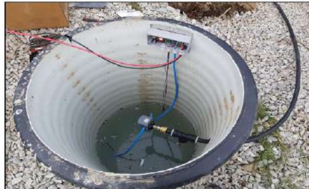
Puisard et pompe de relevage
